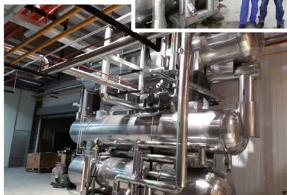
Каскадная CO 2 холодильная система, Тайвань
