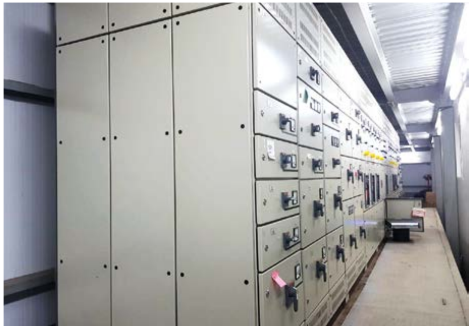
Распределительное устройство РУ-0,4 кВ, оборудованное автоматами АВВ серии Tmax, с включенными опциями СКУД. Рыбоперерабатывающий завод в с. Кичига, Карагинского района, Камчатского края
