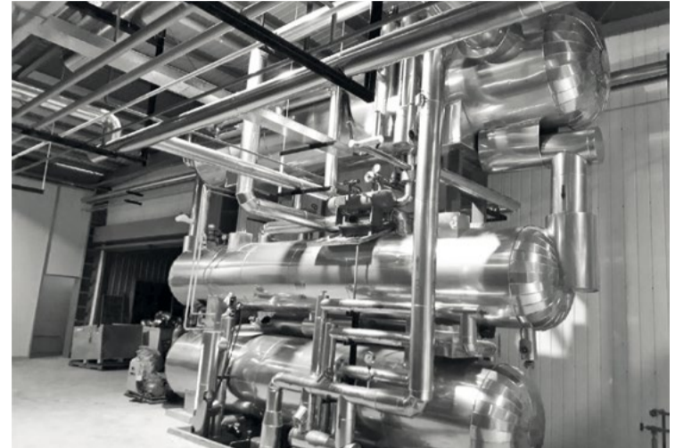
Каскадная CO 2 холодильная система, Тайвань
