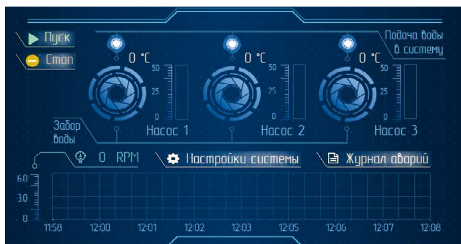
Сенсорная панель управления насосной станцией рыбоперерабатывающего завода также спроектирована специалистами ДРТЦ
