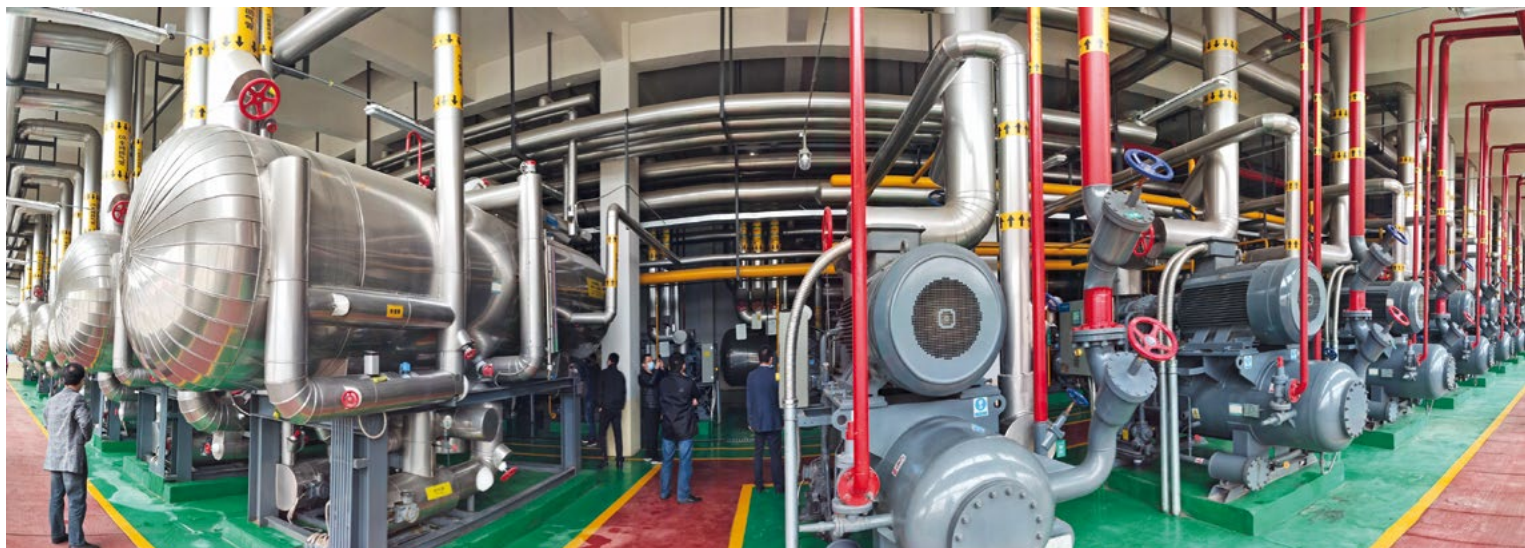
С запуском второй очереди холодильников крупнейший завод по переработке кальмара Haidu сможет обеспечить хранение более 250 тыс. тонн (машинное отделение)
