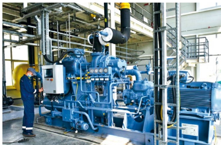
Аммиачная система холодоснабжения на рыбоперерабатывающем комплексе ООО «Русский минтай»
